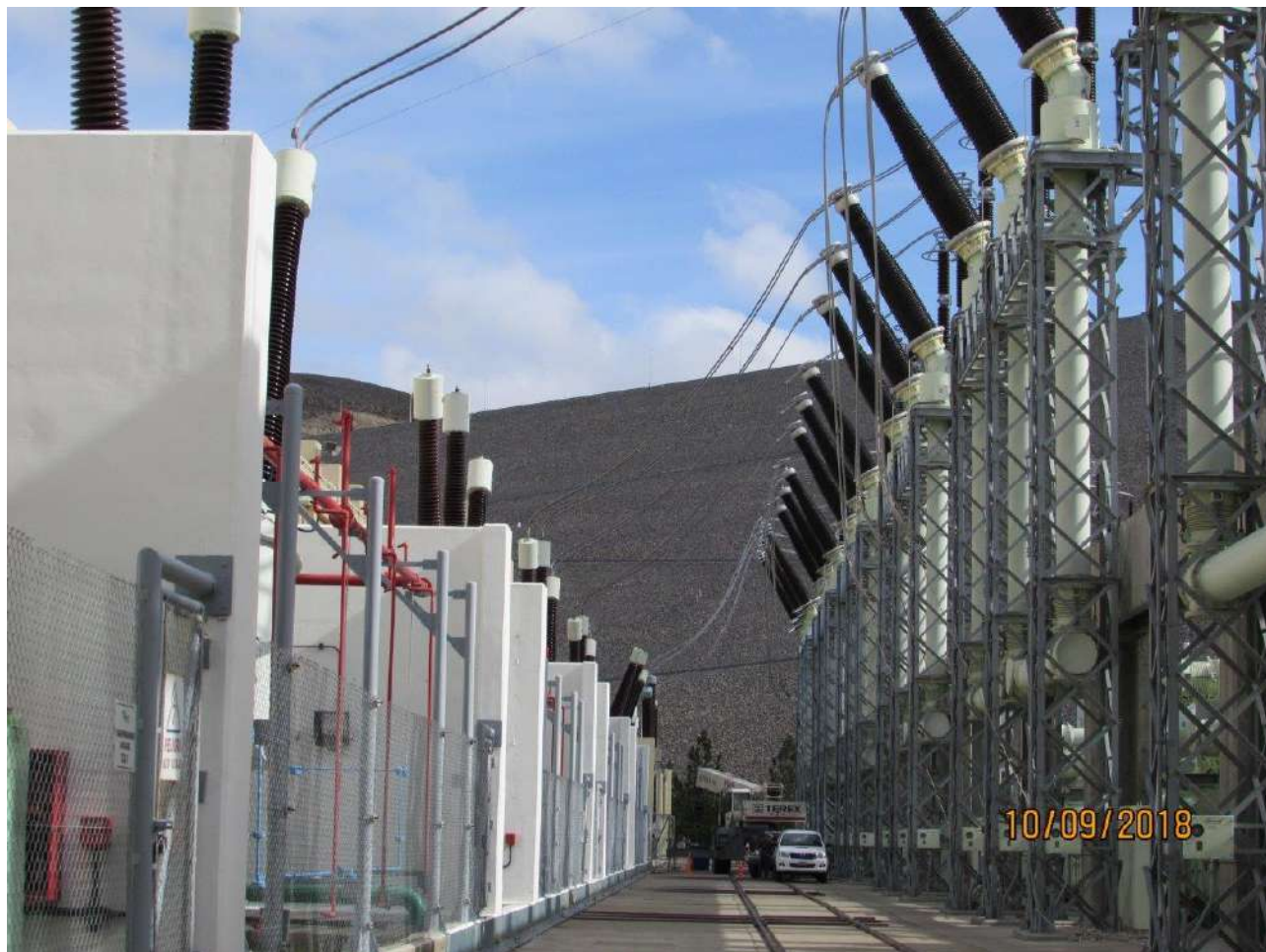
Subestación 500KV, central Alicura
