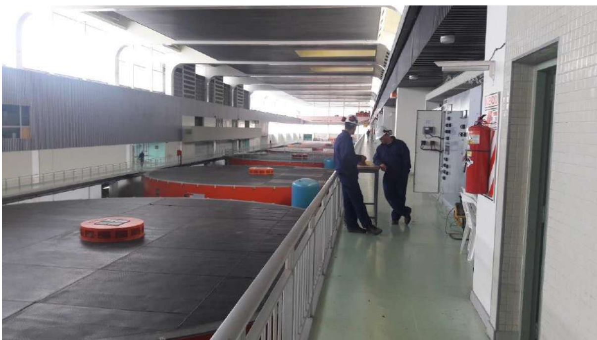
Sala de máquinas central El Chocón
