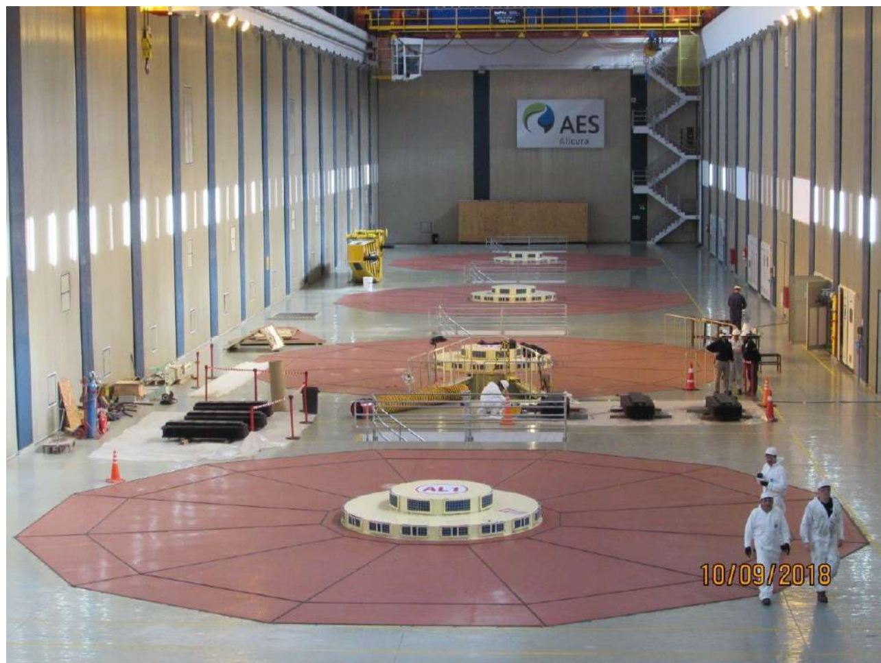
Sala de Máquinas, Central Hidroeléctrica Alicura
